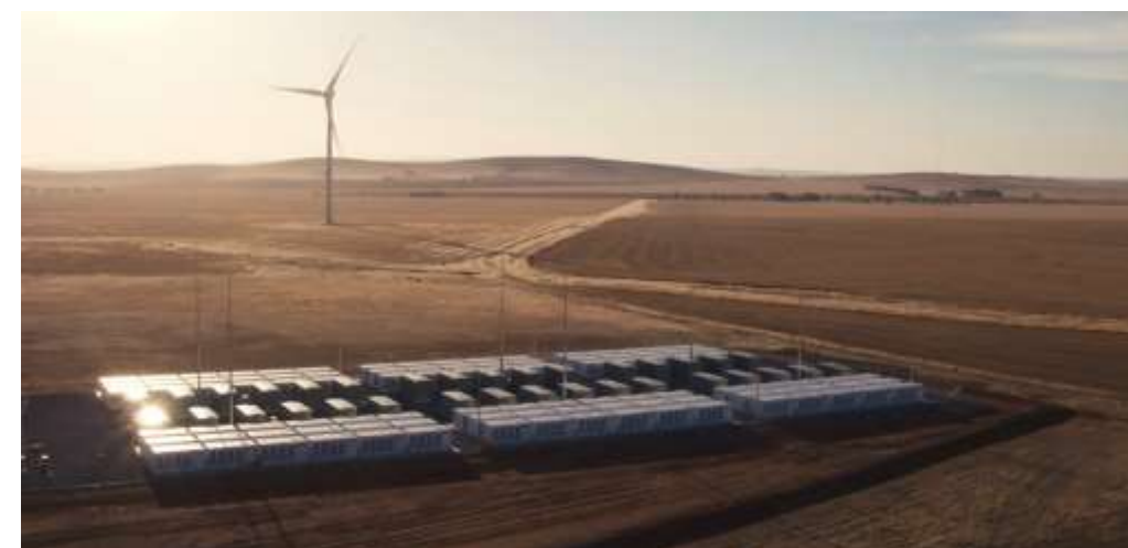
Tesla 100 MW/129 MWh Powerpack
